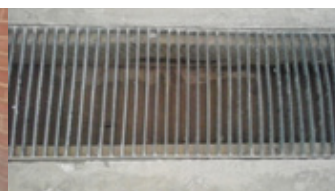
Figura 6. Drenaje externos con rejilla de protección de platinas
