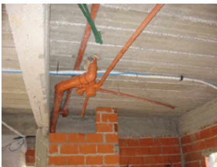
Figura 50. Tuberías de agua elevadas en plantas de proceso
