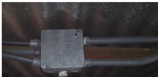
Figura 27. Caja de protección de conexión eléctrica
