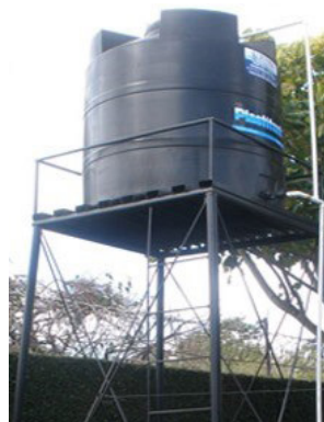
Figura 43. Tanque aéreo de almacenamiento de agua
