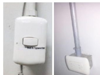
Figura 26. Tomas de corriente y apagadores en tubos
